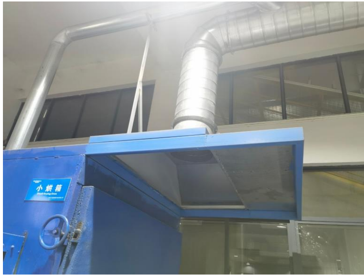
图 3.1-8 烘箱天然气燃烧废气收集装置现场图
