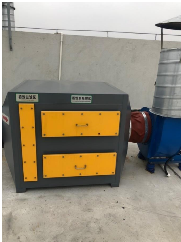
图 3.1-5 活性炭吸附装置现场图
