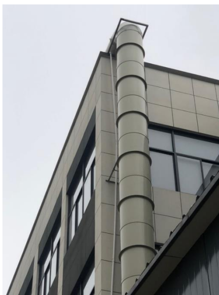
图 3.1-2 酸雾废气排气筒现场图
