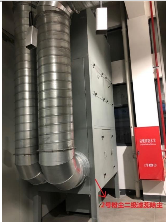
图 3.1-4 喷塑台喷塑粉尘处理设施现场图
