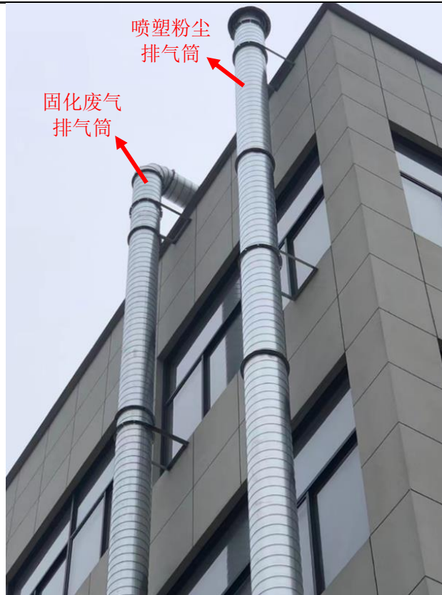
图 3.1-6 固化废气及喷塑粉尘排气筒现场图
