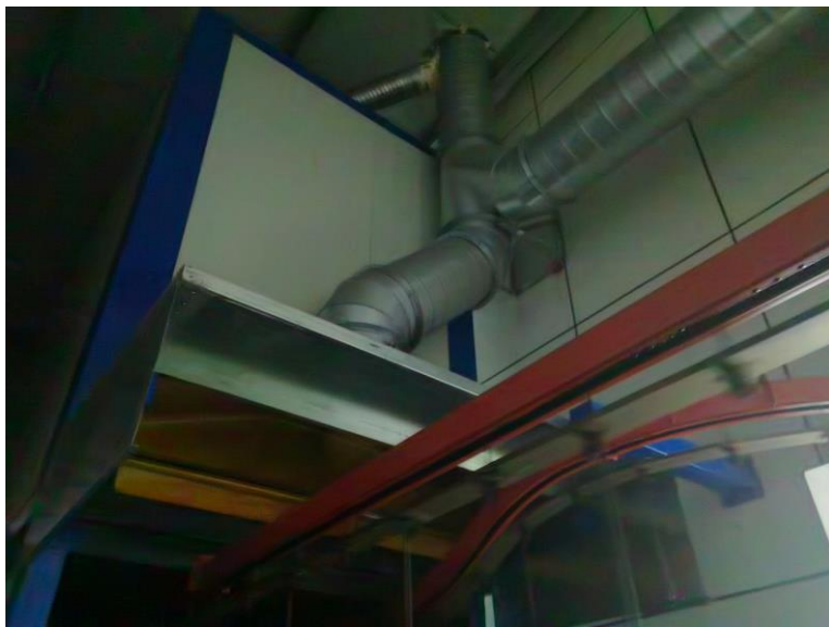
图 3.1-7 喷塑线烘道天然气燃烧废气收集装置现场图
