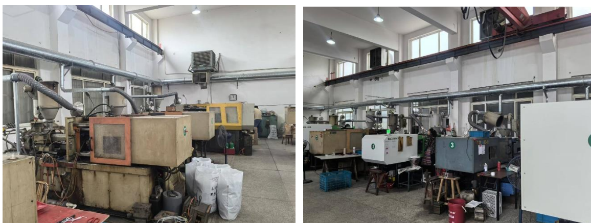
图 3.1-1 注塑车间收集装置
