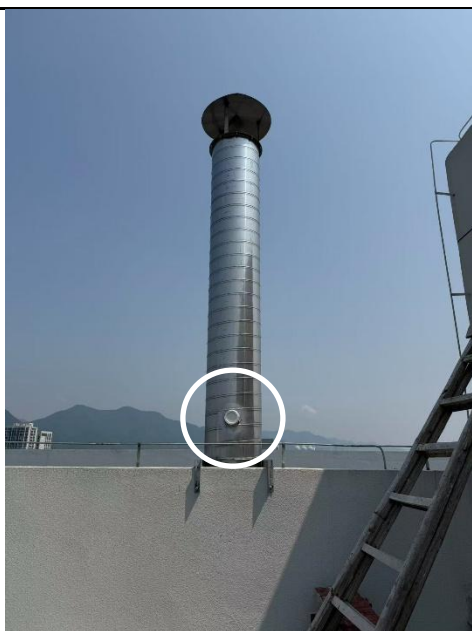
废气排气筒 DA001 出口采样口
