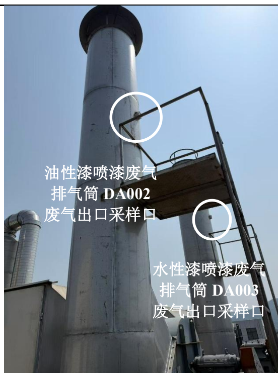
废气排气筒废气出口采样口
