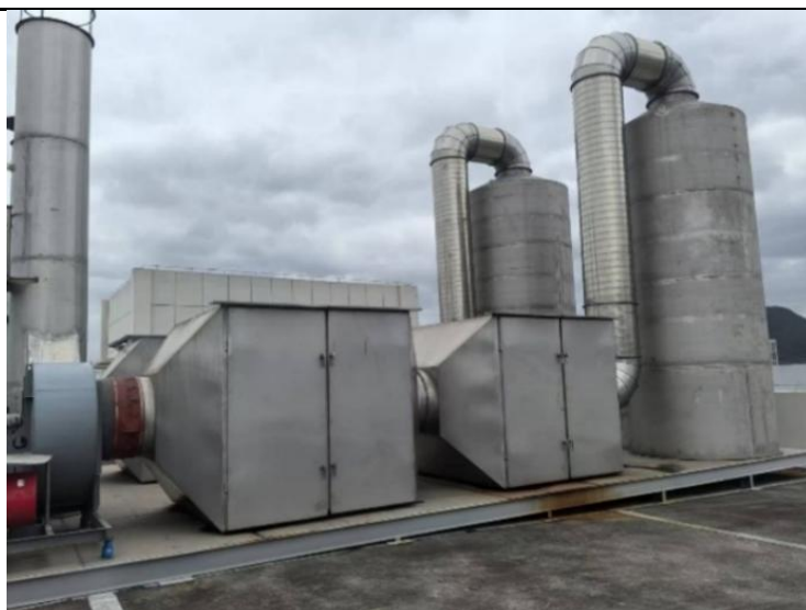
水喷淋+二级活性炭吸附装置 2#
