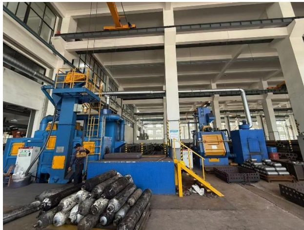
抛丸机及对应废气收集管道
