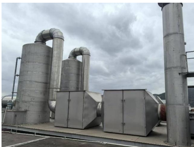
水喷淋+二级活性炭吸附装置 1#
